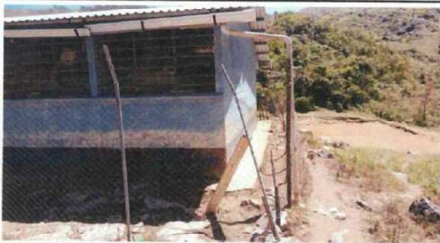
foto 3. el area perimetral del establecimiento esta deteriorada
