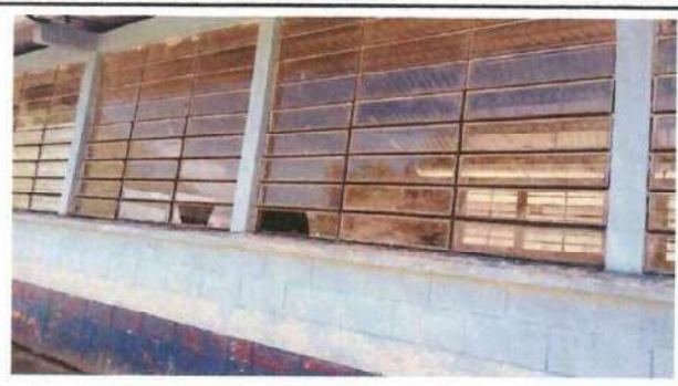
foto 4. algunos vidrios estan quebrados
