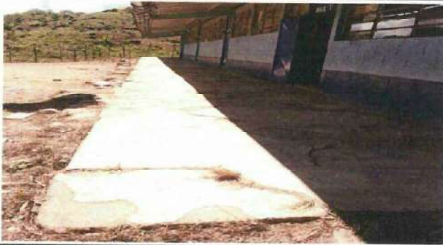
foto 1. El piso del corredor de la escuela esta deteriorada, con grietas.
