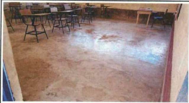
foto 2. el piso dentro de las aulas estan en mal estado, lo que necesita realizar un cambio
