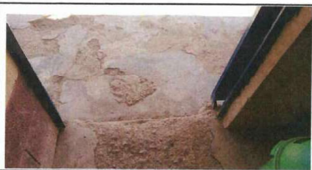
foto 6. el piso del corredor y las aulas estan en mal estado
